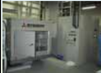
DME コジェネレーション用発電機
